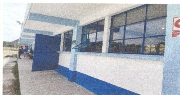
Foto1: PUERTAS DE METAL
