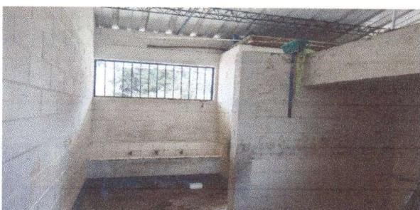
Foto 5: SERVICIOS SANITARIOS Y SUS ACCESORIOS
